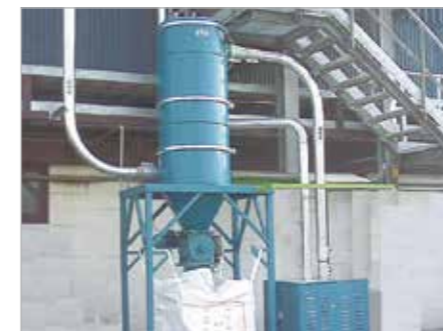
中央气泵 Central air pump
